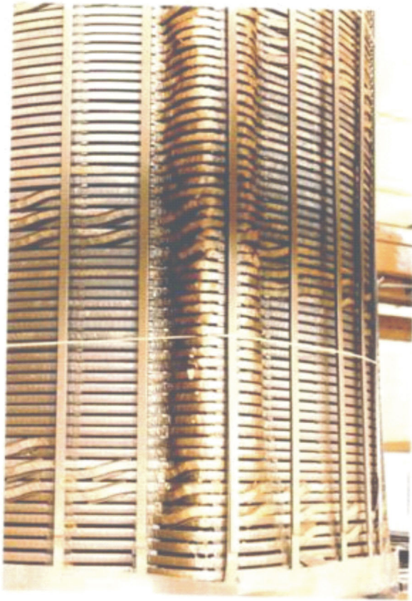
Figura 3-3: Deformação da bobina radial
