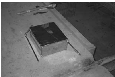
Puntos de entrada y rebose conectados a la parte delantera del carro de horno.
